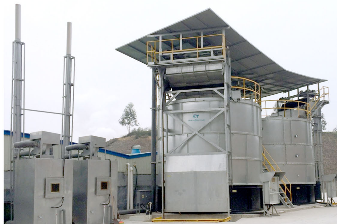
除臭塔/发酵设备
